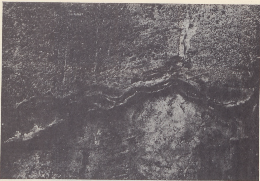
Fig. 3. Skorpelignende, indtørrede, sekundære udfældninger af kalcit (kalciumkarbonat) over revner i lodret betonoverflade. Udfældningernes højde er ca. 3—5 mm. Fra (56 I 1).
