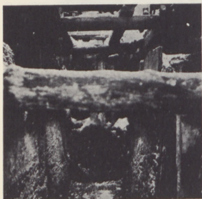
Fig. 15. Injiceret sand (under grundvandspejlet) ved et kloakarbejde langs med en flod. Bemærk sidevæggene, der viser det injicerede sandlag, der er bearbejdet med buggeværktøj.
