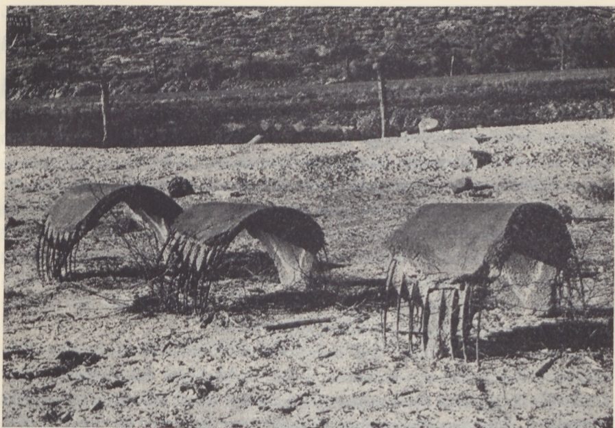
Fig. 8. Rester af betonrør efter få års udlægning i „alkali soils“ i Grand Junction, Colorado, U.S.A. Utvivlsomt har den kapillære opsugning af koncentrerede alkali-sulfatopløsninger fra jordbunden i forbindelse med meget stærk fordampning i det tørre, varme klima bevirket en ualmindelig hurtig nedbrydning. Foto Ervin Poulsen.
