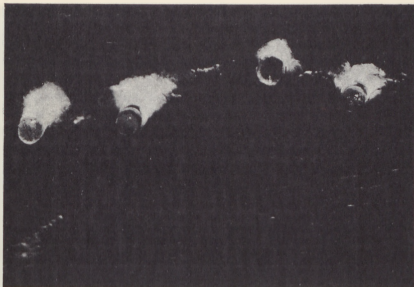
Fig. 4. Stalaktitter af kalcit under udfældning fra overmættet \text{Ca}(\text{OH})_2 -opløsning i revne på undersiden af betonloft i bropille med skadelige alkalireaktioner. Diameter af dråber er ca. 5 mm. Fra (5611).
